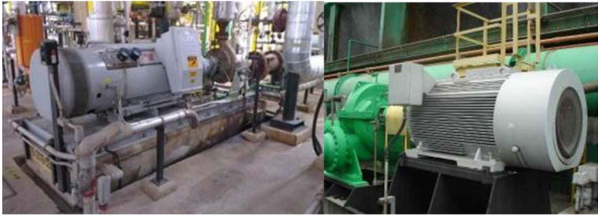
Figura 6 - Exemplos de motores elétricos industriais instalados em unidades industriais da Petrobras, protegidos por relés digitais microprocessados (IED) contendo função de proteção térmica (F. 49 / PTTR). Fonte: O AUTOR, 2018.
