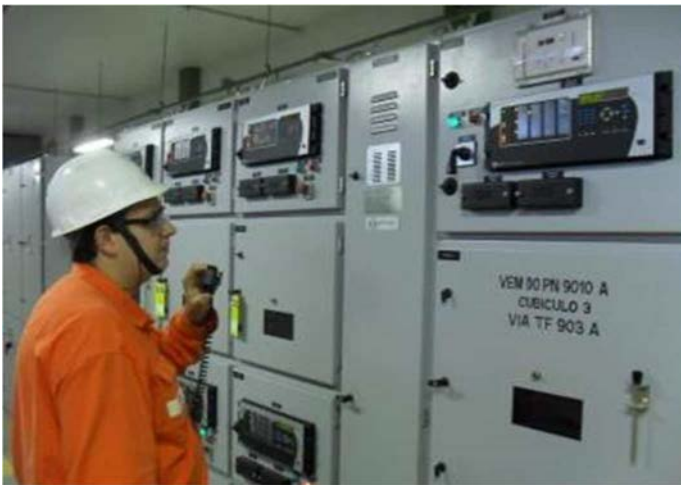
Figura 7 - Exemplo de painel elétrico existente em subestação de Unidade Operacional da Petrobras, contendo relés digitais microprocessados (IED) com a função de proteção térmica (F. 49 / PTTR) para motores elétricos industriais. Fonte: O AUTOR, 2018.
