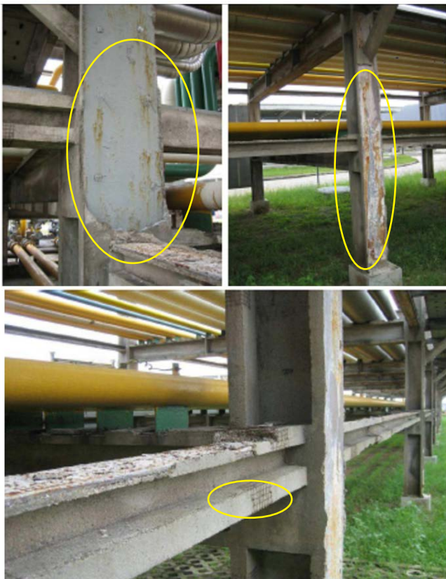
Figura 1 - Exemplos de danos no fireproofing de estruturas industriais.
