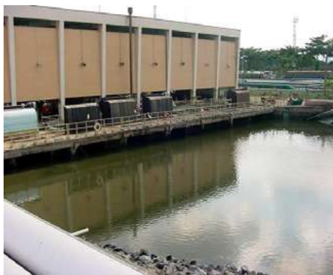
Figura 1 - Unidade antiga de Refrigeração da Bacia de Resfriamento.
