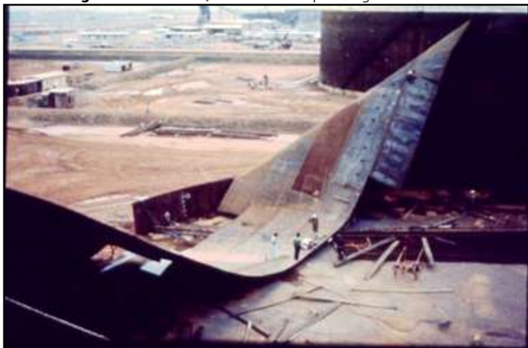
Figura 3 – Deformação do costado por carga de vento.
