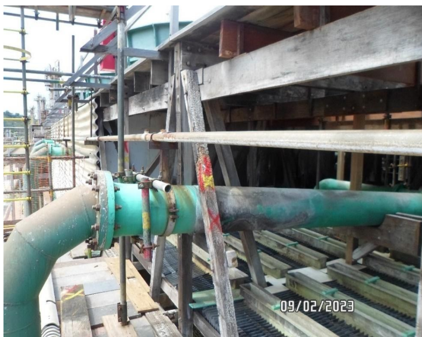
Foto 1. Madeira marcada para substituição.
