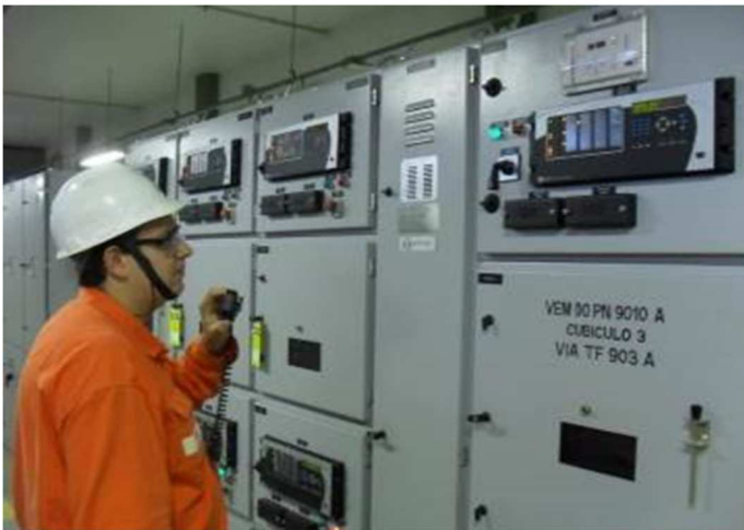
Figura 7 - Exemplo de painel elétrico existente em subestação de Unidade Operacional da Petrobras, contendo relés digitais microprocessados (IED) com a função de proteção térmica (F. 49 / PTTR) para motores elétricos industriais.
