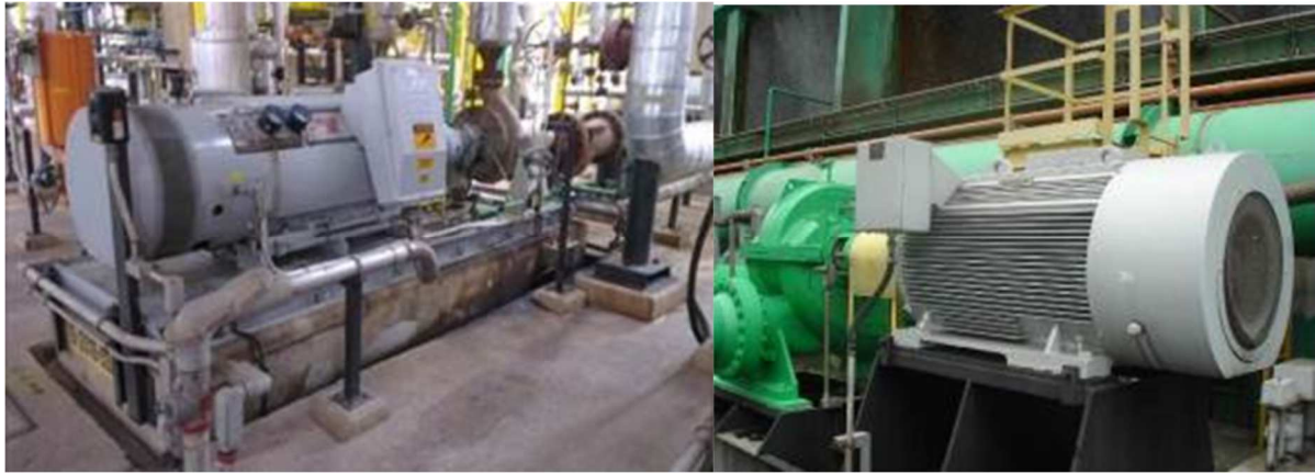
Figura 6 - Exemplos de motores elétricos industriais instalados em unidades industriais da Petrobras, protegidos por relés digitais microprocessados (IED) contendo função de proteção térmica (F. 49 / PTTR).
