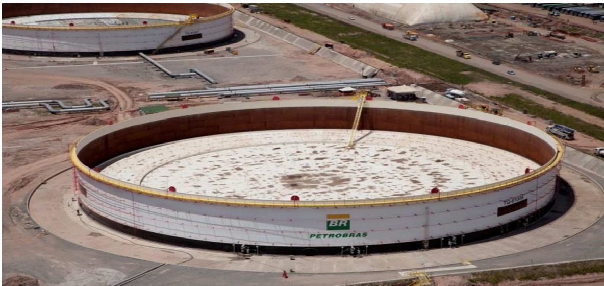
Figura 6 - Tanque de petróleo da RNEST.
