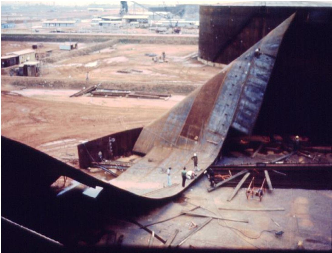
Figura 3 - Deformação do costado por carga de vento.
