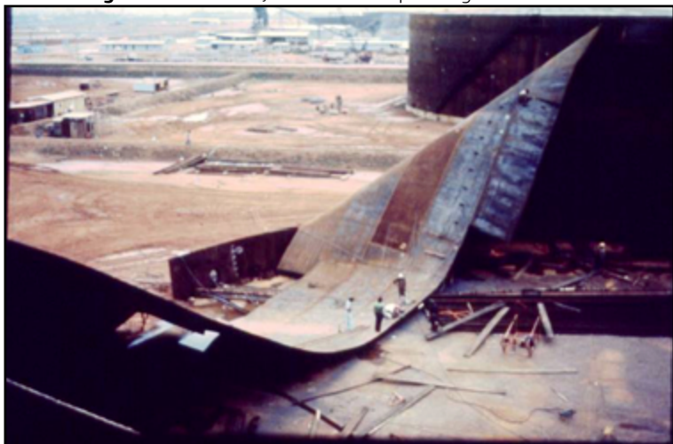
Figura 3 – Deformação do costado por carga de vento.
